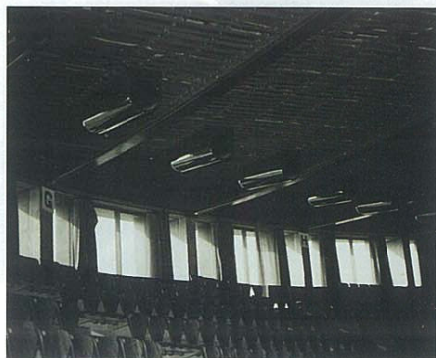
客席上部の空調用吹出しノズル
